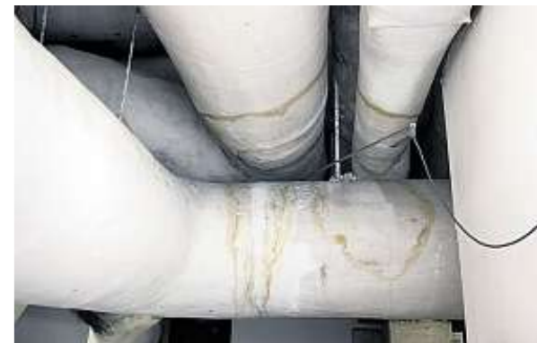
Blick in die Eingeweide – Alte Lüftungsrohre im Keller der Neuen Nationalgalerie
