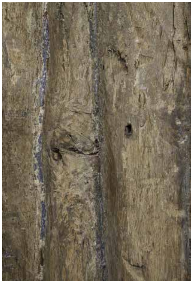
Abb. 28: Eckiges Loch einer Eisenklammer an der linken Seite des Mantels
